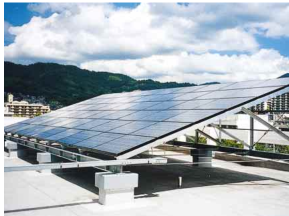
「太陽光発電システム」 (呉高専殿納め)
