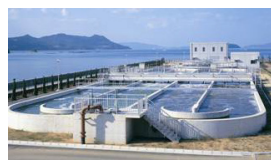
水処理プラント
