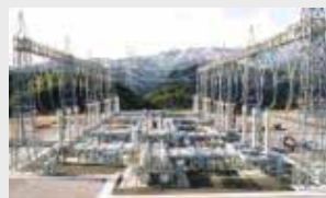
電力流通 システム
