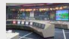
中央制御操作盤
